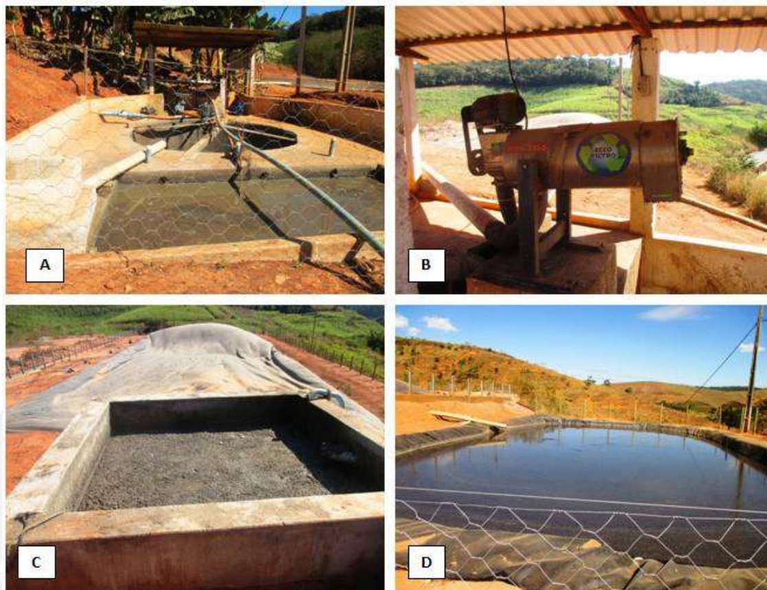
Figura 6 – Sistema de tratamento de efluentes instalado no empreendimento: (A) caixa de retenção de sólidos e tanque equalizador; (B) Ecofiltro; (C) Biodigestor e; (D) primeira das três lagoas de tratamento.
