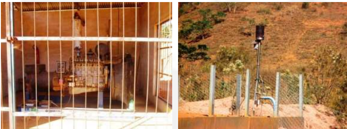
Figura 8 – Gerador de energia que aproveita o gás gerado no biodigestor e flare.
