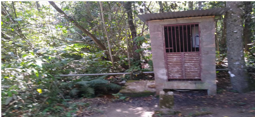
Captação em Nascente
