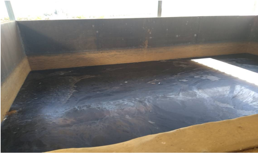
Tanque armazenador de resíduos da lavagem dos frutos
