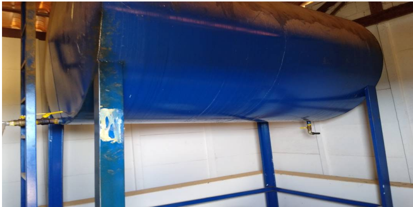
Tanque Aéreo de Diesel
