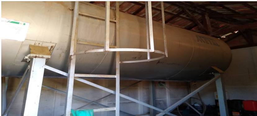
Tanque de Combustível
