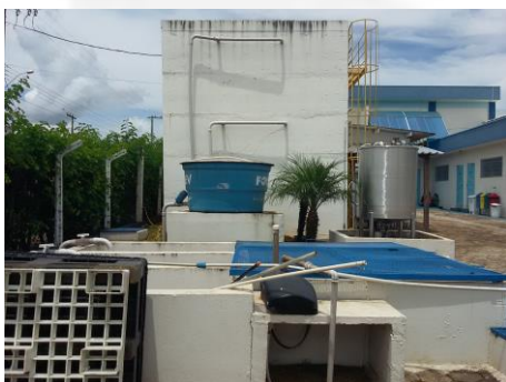
Foto 05. Estação de tratamento de efluentes.
