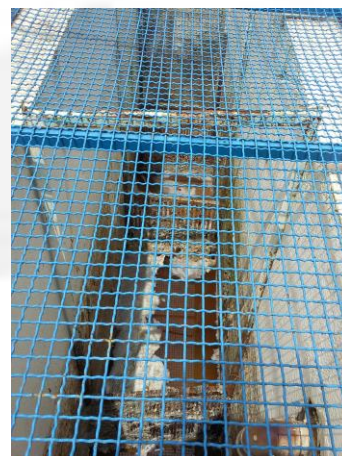
Foto 06. Detalhe da ETE (gradeamento).
