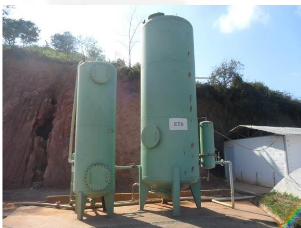
Foto 03. Estação de Tratamento de água.
