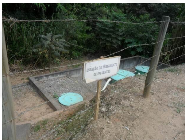
Foto 04. Estação de tratamento de efluentes sanitários
