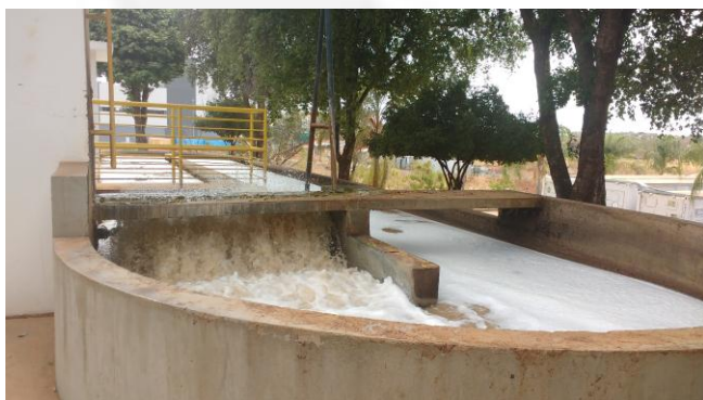
Foto 3 – Estação de Tratamento de efluentes
