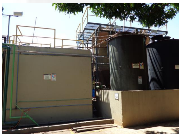
Estação de tratamento de efluentes
