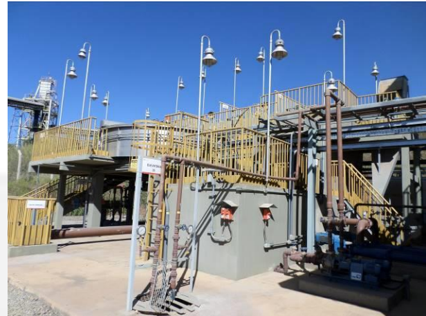
Foto 02. Estação de tratamento de efluentes.
