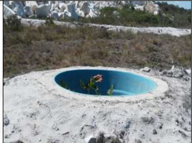
Foto 14: Filtro de fossa séptica.
