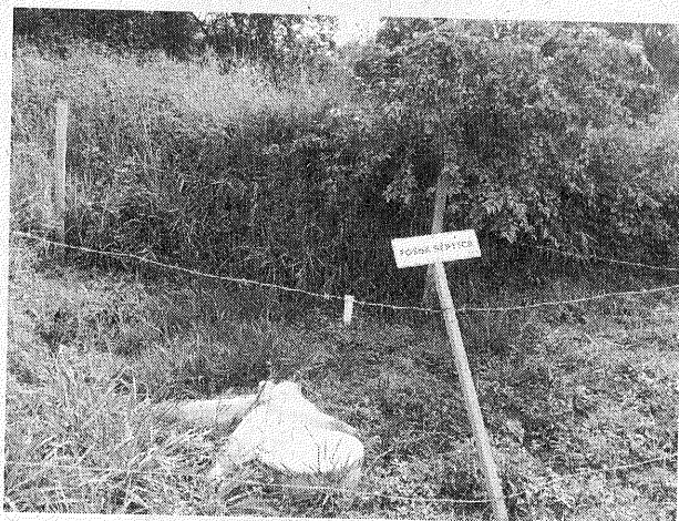
Foto 07. Fossa séptica do banheiro da usina.
