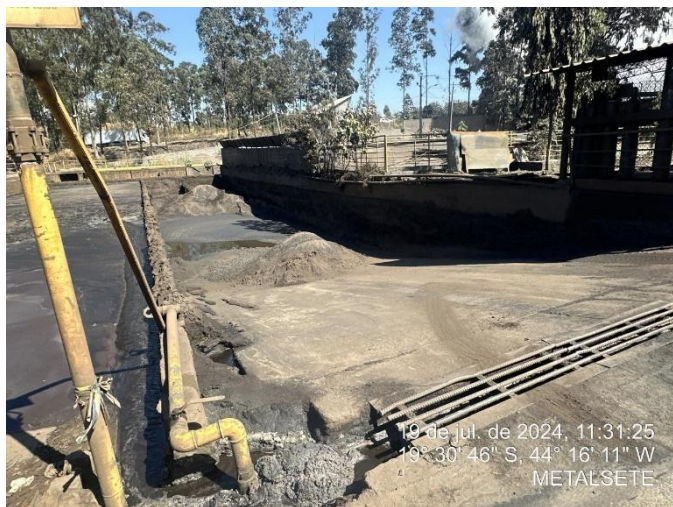
Foto 7: Canaleta que direciona lama do lavador de gás até o tanque de pó de balão.
