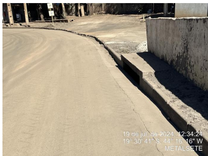
Foto 27: Canaleta nas vias de acesso da Metalsete;
