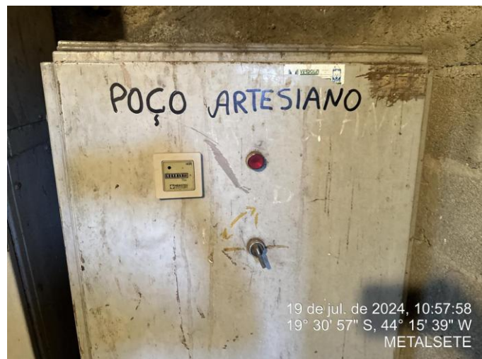
Foto 62: Horímetro do poço de água potável, localizado na Siderdias
