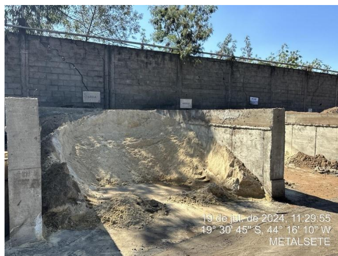
Foto 38: Baía localizada no pátio de minério, evidenciando acondicionamento da argila
