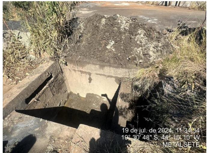
Figura 15. Caixa de decantação próximo ao pátio de minério
