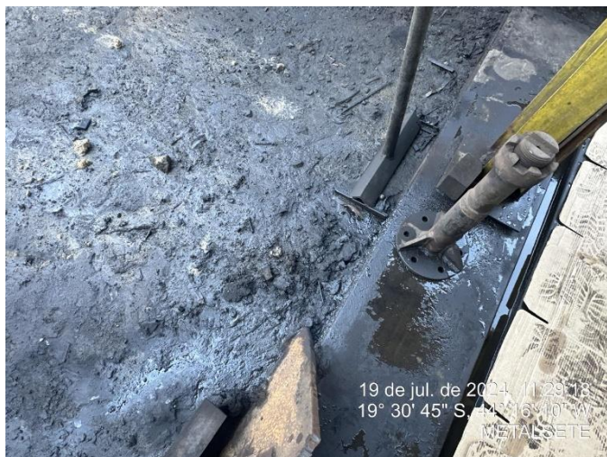
Foto 57: Área sem pavimentação ao lado da oficina, aparentemente com óleo
