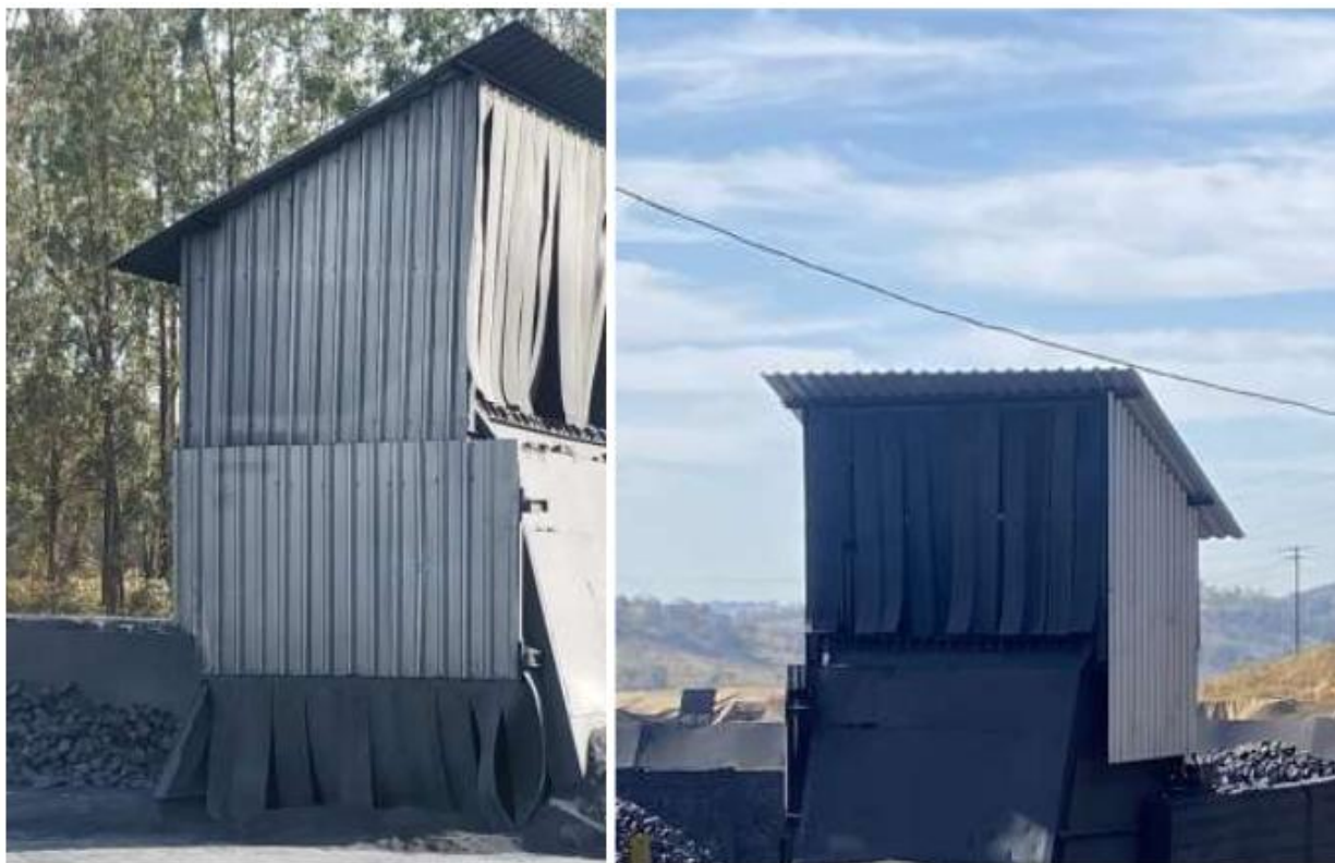
Figura 17. Enclausuramento do tamboramento visando a mitigação dos impactos provenientes da emissão de material particulados no carregamento do ferro gusa
