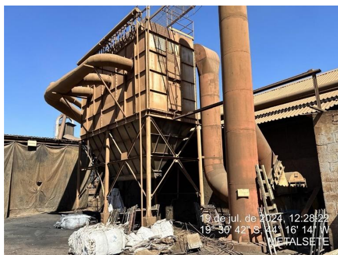
Foto 21: Filtro de mangas no descarregamento do minério mais resíduos diversos;
