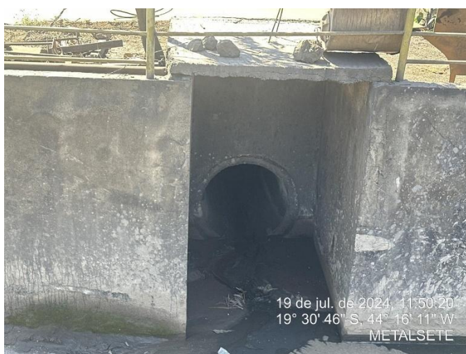
Foto 33: Manilha presente no sistema da bacia de decantação.
