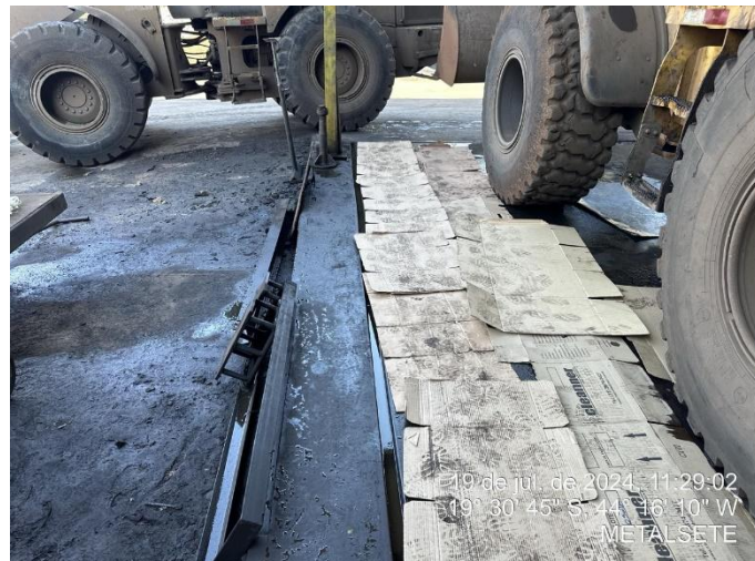
Foto 58: Área sem pavimentação ao lado da oficina, com manchas que aparentam serem de óleo
