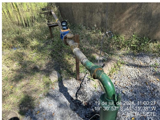
Foto 63: Poço de água industrial – ausência de laje de proteção além de estar localizado em propriedade de terceiro.
