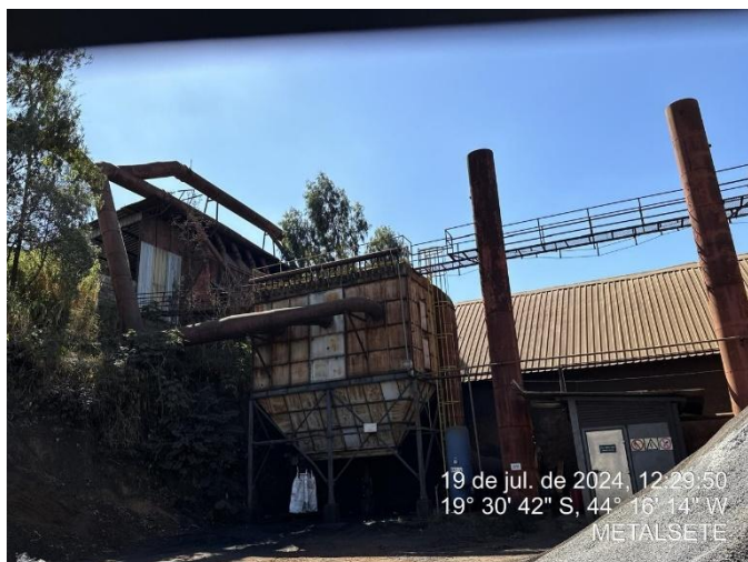
Foto 15: Filtro de mangas do galpão de carvão;
