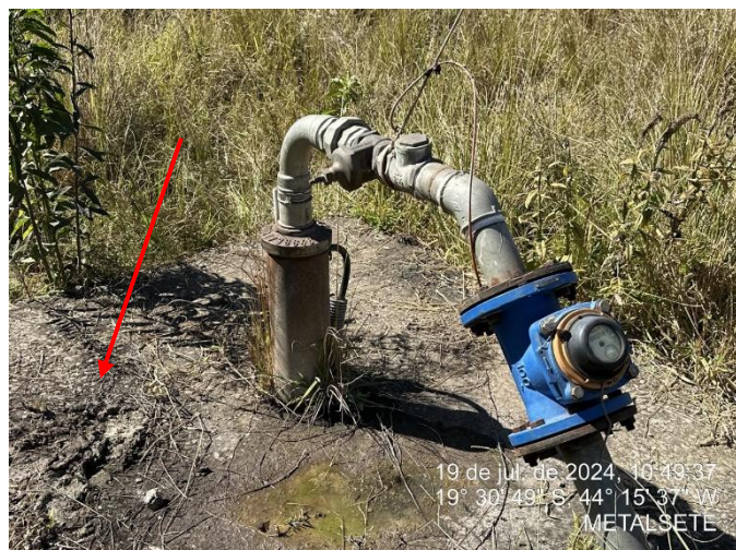
Foto 61: Poço de água potável, localizado na Siderdias. Sete vermelha indicando fezes de animais – ausência de laje de proteção adequada;
