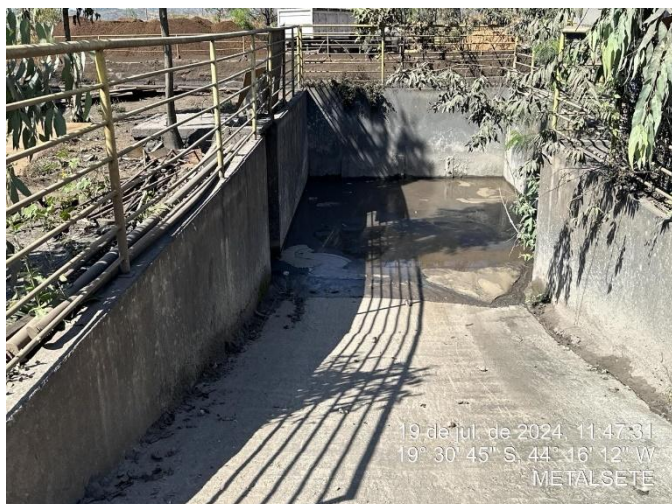
Foto 31: Bacia de decantação
