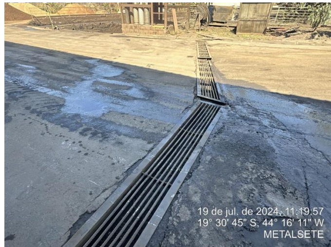
Foto 8: Canaleta que direciona lama do lavador de gás até o tanque. Vista da saída do alto-forno sentido ao tanque de pó de balão;
