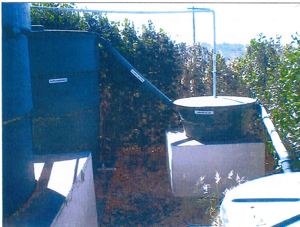
Figura 9. Estação de Tratamento de Efluentes – ETE (Geral)
