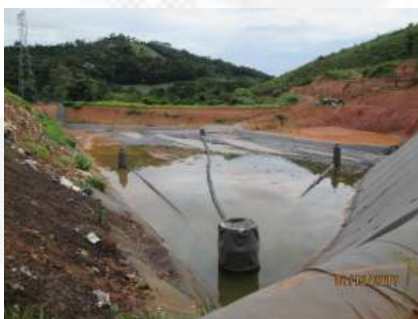
Foto 04. Célula instalada com sistemas de drenagem, dreno testemunho e camadas de impermeabilização. A água de chuva será retirada e as mantas serão reorganizadas.
