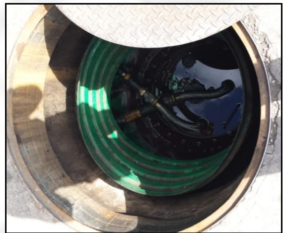
Foto 04. Tanque subterrâneo de armazenamento de combustível.
