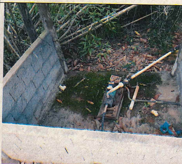
Foto 06: Poço tubular (Faz. Caiçara).
