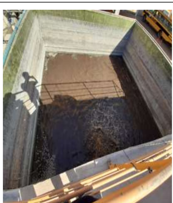
Figura 02: tanque de equalização
