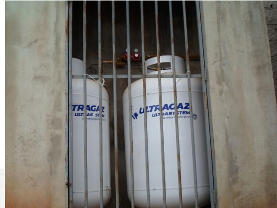
Foto 06. Depósito de gás
