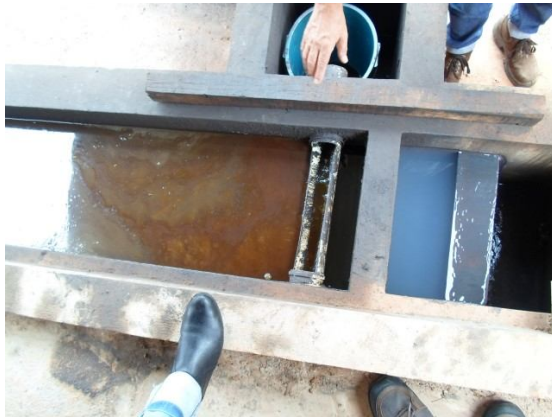
Foto 05. Sistema de separação de efluentes
