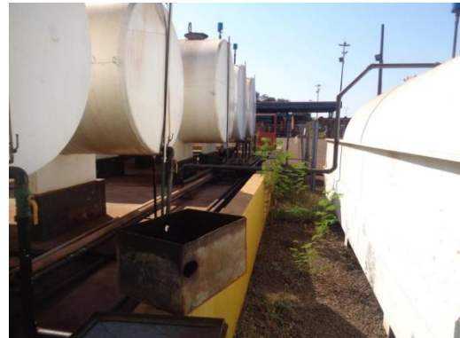
Figura 4- Bacia de contenção
