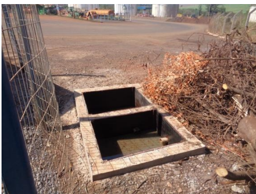
Figura 5- Caixa separadora de água e óleo
