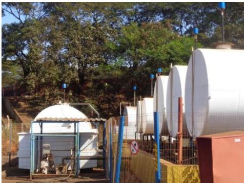
Figura 3- Tanques aéreos de combustíveis
