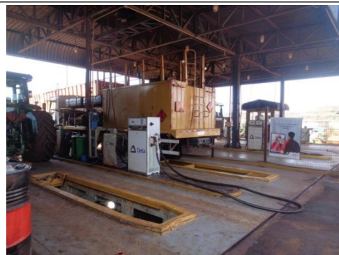
Figura 2- Pista de troca de óleo
