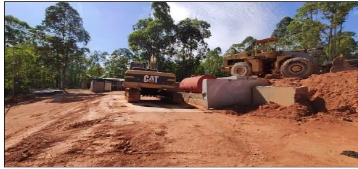
Figura 5: vista do tanque de abastecimento móvel, capacidade de xxx. Notar piso impermeável e bacia de contenção no caso de eventuais vazamentos.
