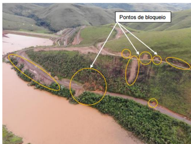
Figura 2-5 – Talude onde ocorreram deslizamentos de terra.
