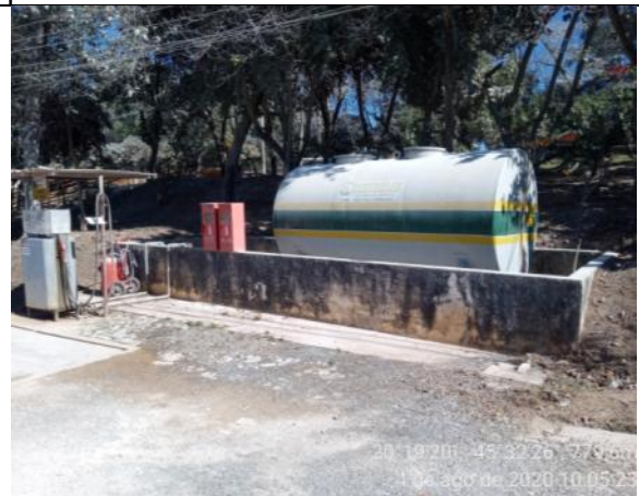
Foto 10. Tanque aéreo e área de abastecimento.
