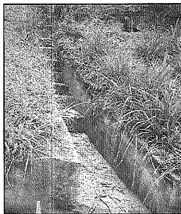
Foto 07. Dispositivos de drenagem pluvial (canaletas e escada de dissipação).
