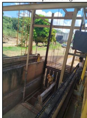
Foto 14: Elevador de peixes - STP
