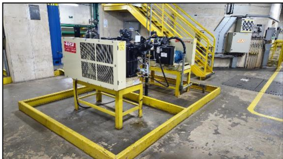
Foto 9: Barreiras de contenção de vazamentos
