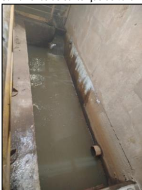
Foto 11: Sistema de drenagem de percolados
