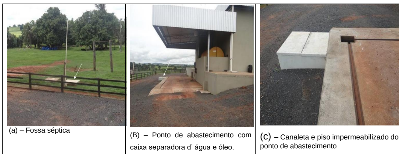
Figura 5 – Fossa séptica e ponto de abastecimento
