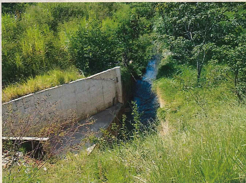
Drenagem pluvial com intersecção no leito do Córrego Perpétua
