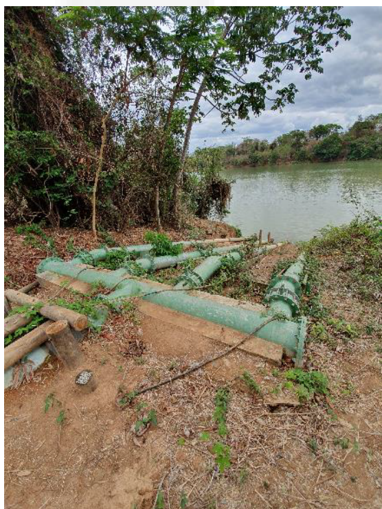
Foto 03. Captação no Rio Paracatu
