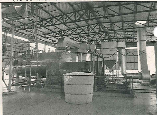
Foto 10: Área auxiliar - equipamento para demanda térmica existente (18°50'48.83"S/48°17'44.18"O); 30/11/2018.
