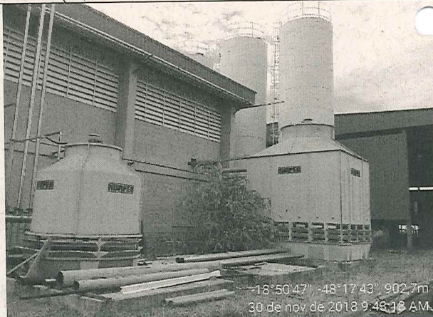
Foto 08: Área auxiliar - torres de resfriamento (18°50'47.67"S/48°17'44.07"O); 30/11/2018.
