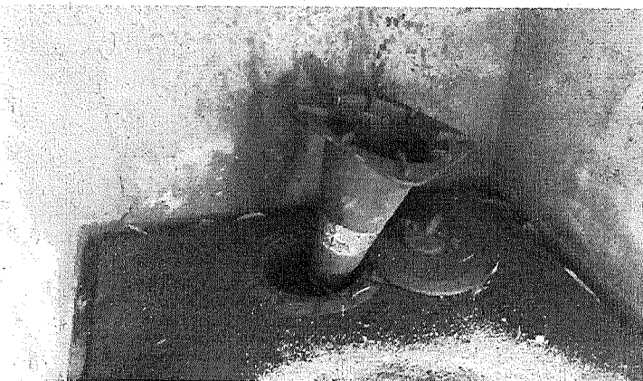
Foto 11 – Bocal do tanque de armazenamento de óleo usado.
