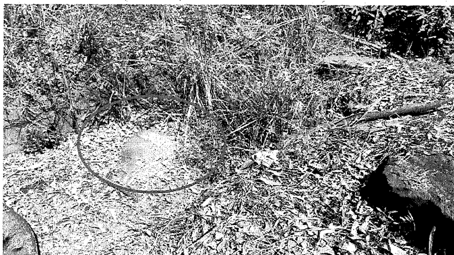
Foto 16 – Filtro anaeróbico da fossa séptica.
