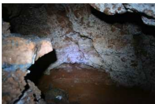
Figura 124. Fungos nas paredes internas da cavidade.
