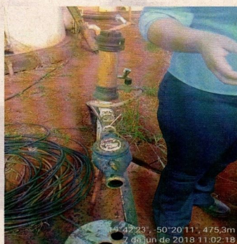
Figura 11- Hidrômetro e demais estruturas do poço.
