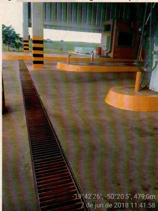
Figura 4- Canaletas de drenagem oleosa
