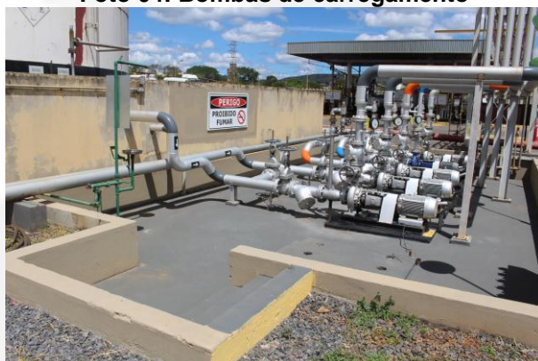
Foto 04: Bombas de carregamento
