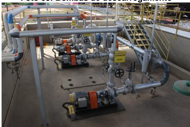
Foto 03: Bombas de descarregamento
