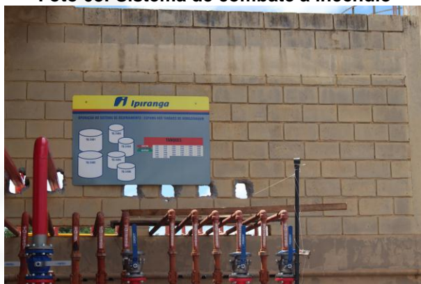
Foto 08: Sistema de combate a incêndio
