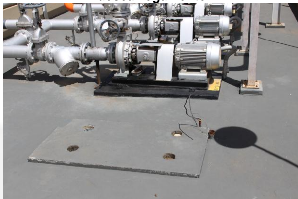
Foto 06: Local da instalação da bomba de descarregamento
