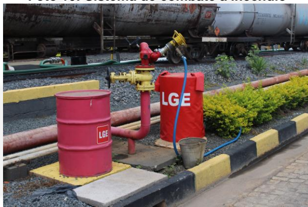
Foto 10: Sistema de combate a incêndio
