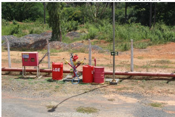
Foto 09: Sistema de combate a incêndio
