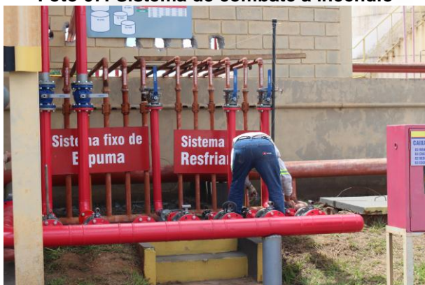
Foto 07: Sistema de combate a incêndio
