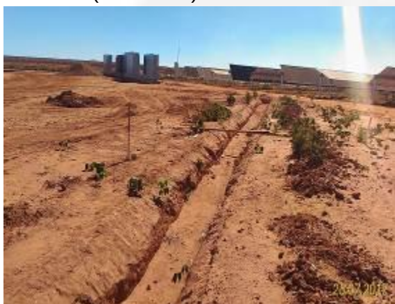
Foto 07. Canaletas sistema drenagem
