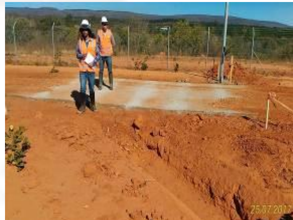
Foto 08. Caixas passagem sistema de drenagem
