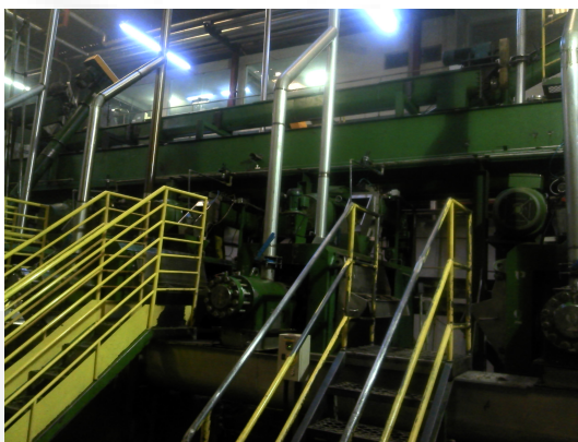
Equipamentos da área interna industrial
