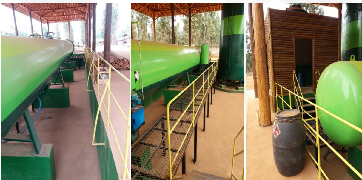
Fotos 3, 4 e 5: Autoclave, fosso e depósito de preservativos e neutralizantes.
