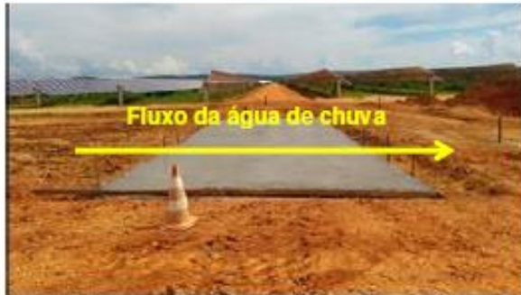
FOTO 2.1: CONSTRUÇÃO DAS LAGES DE CONCRETO EM PONTOS DE CONVERGÊNCIA DA ÁGUA PLUVIAL.
