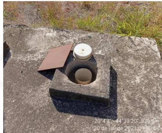
Foto 04. ETE sanitária atualmente fora de operação.
