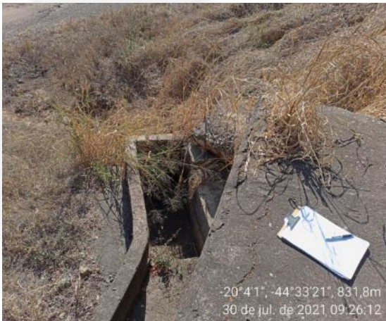
Foto 03. Local de liberação de efluentes pluviais no sistema do município.
