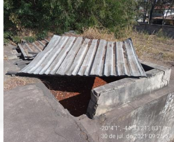
Foto 02. Tanque para retenção de sedimentos.
