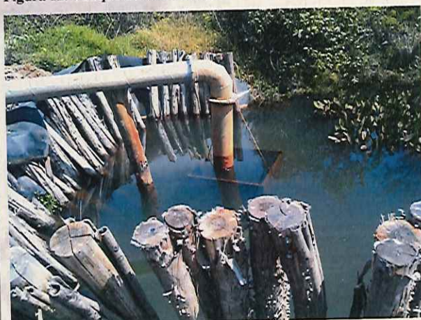
Figura 14. Captação de água superficial
