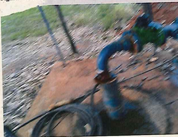
Figura 13. Captação de água subterrânea
