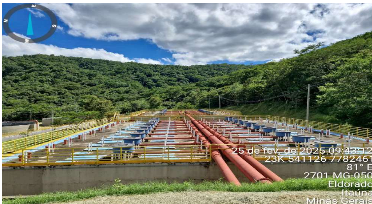
Figura 4 – Reatores UASB. Fonte: Equipe técnica da URA – ASF.
