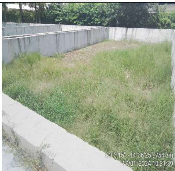
Foto 11. Leitos de secagem do lodo
