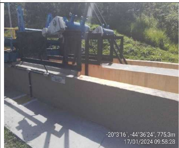
Foto 03. Tratamento preliminar (gradeamento mecanizado).
