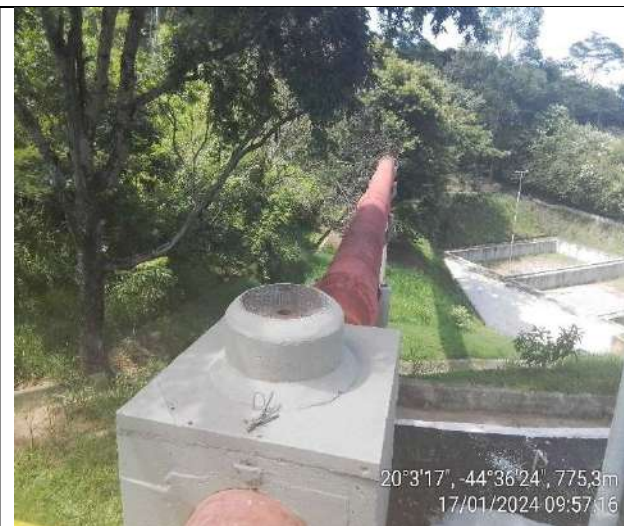
Foto 01. Emissário do esgoto bruto.
