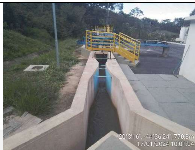
Foto 04. Tratamento preliminar (Medidor de vazão).
