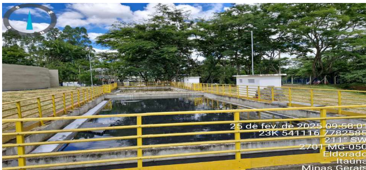
Figura 6 - Decantadores Secundários. Fonte: Equipe técnica da URA – ASF.
