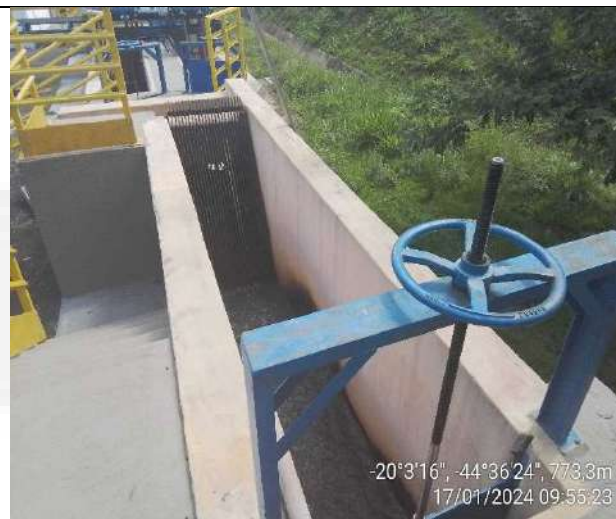
Foto 02. Tratamento preliminar (gradeamento).
