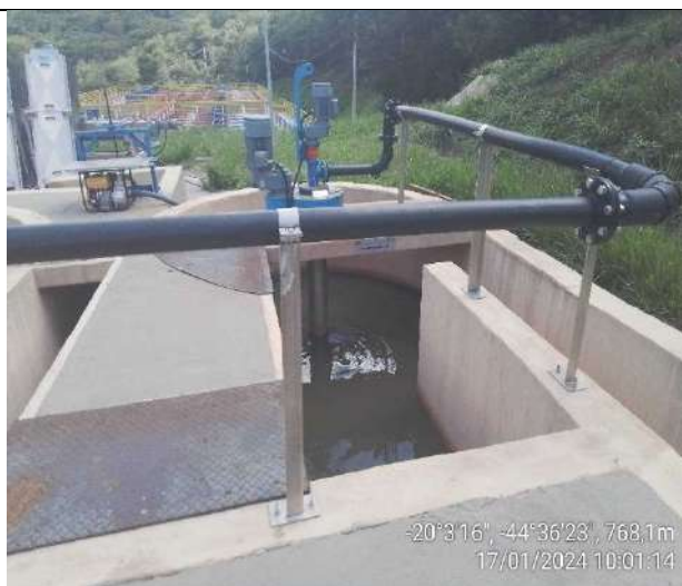
Foto 05. Tratamento preliminar (Desarenadores).
