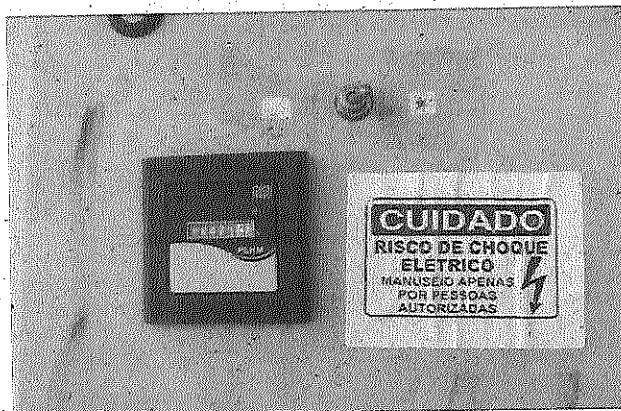
Foto 07 – Horímetro instalado no poço
