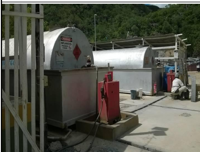
Foto 11: Tanque de Combustível
