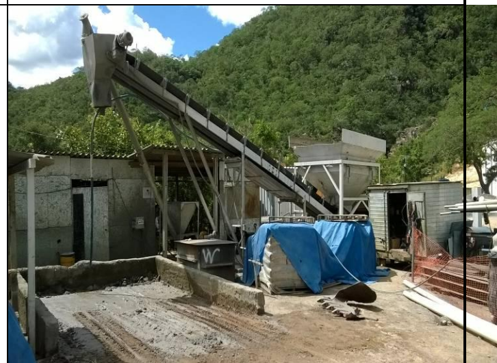
Foto 12: Central de Concreto
