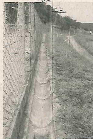
Foto 06. Canaleta para águas pluviais
