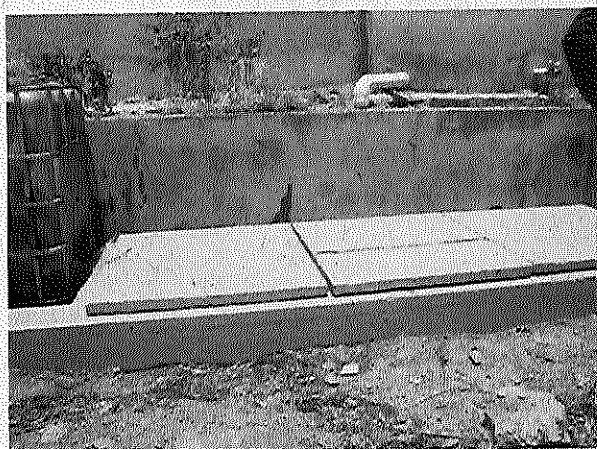
Foto 03. Caixa separadora de água e óleo
