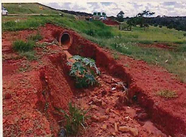
Foto 01. Foco erosivo identificado na área
