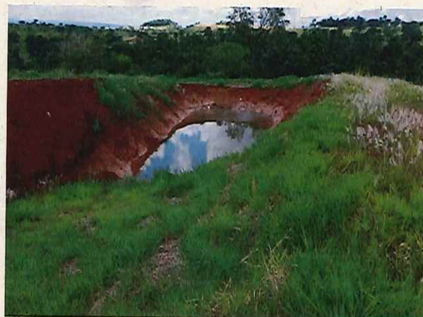
Foto 08. Bolsão de águas pluviais
