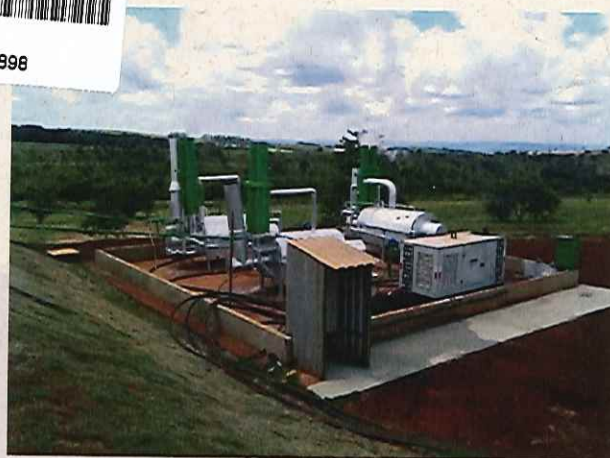
Foto 06. Vista dos evaporadores
