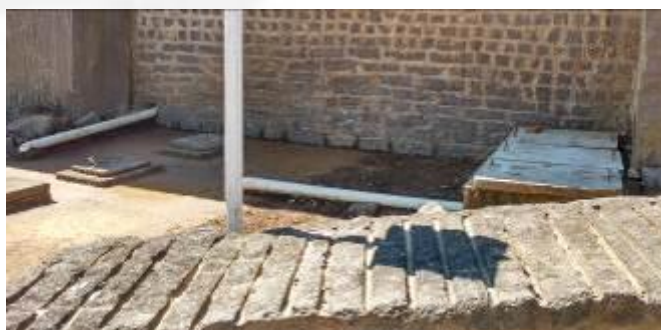
Foto 08. Caixa SAO da oficina mecânica.
