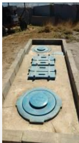
Foto 06. Caixa SAO do ponto de abastecimento.
