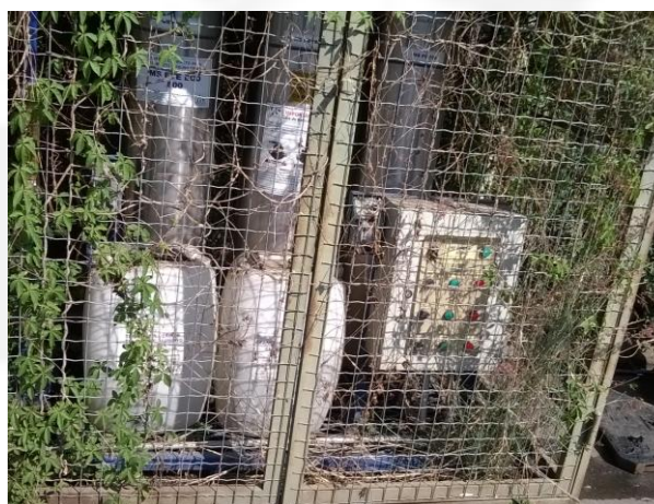
Foto 03. Sistema para tratamento de água de chuva.
