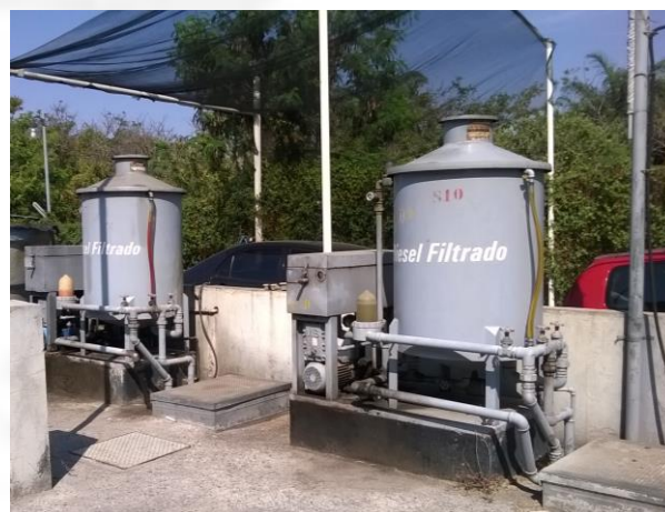
Foto 02. Filtro de óleo com área de contenção
