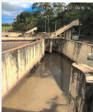
Figura 1: Chegada do esgoto bruto.
