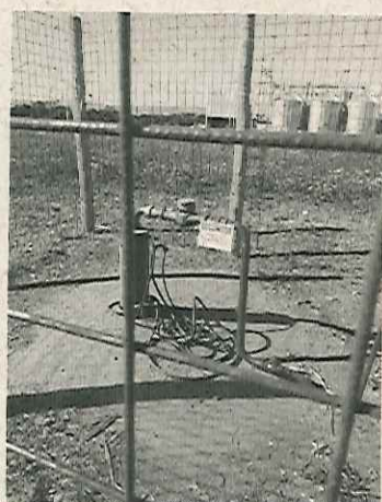
Figura 5. Poço 1 – captação de água subterrânea
