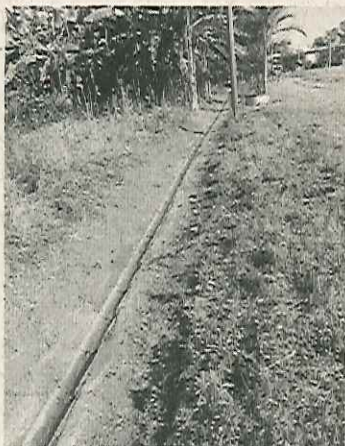
Figura 10. Canaleta de drenagem de vinhaça e águas residuárias industriais
