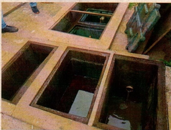
Caixa Separadora de Água e Óleo
