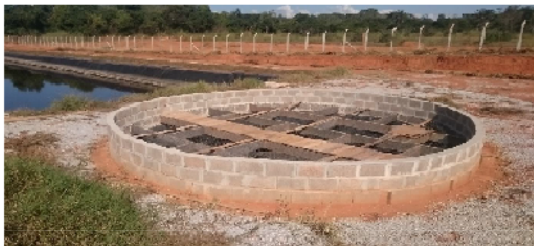
FIGURA 5 – Tanque a naeróbio instalado na ETE do Aterro Sanitário de Paracatu.
