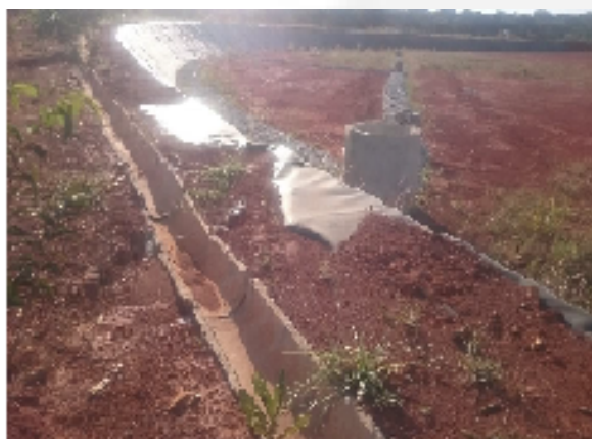
Foto 01. Drenos superficiais componentes do sistema de drenagem pluvial da área do Aterro Sanitário de Paracatu.
