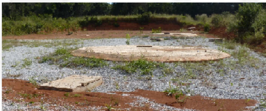
FIGURA 6 – Sistema de tratamento de esgotos do prédio administrativo já instalado (fossa séptica – sumidouros).
