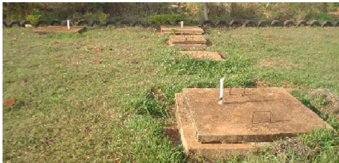
FIGURA 3 – Sistema de tratamento de esgotos do prédio administrativo já instalado (fossa séptica – sumidouros).
