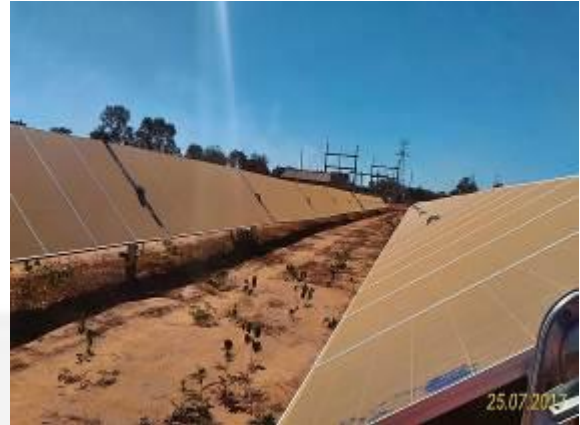
Foto 06. Painéis solares instalados
