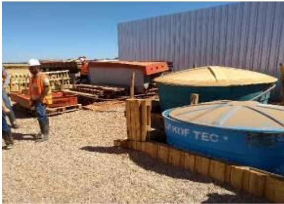
Foto 05. Sistema prévio de tratamento de efluentes (eletrolítico)
