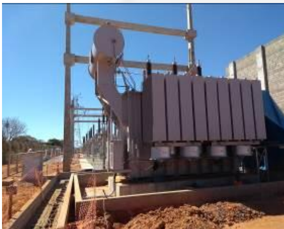
Foto 01. Subestação de energia elétrica
