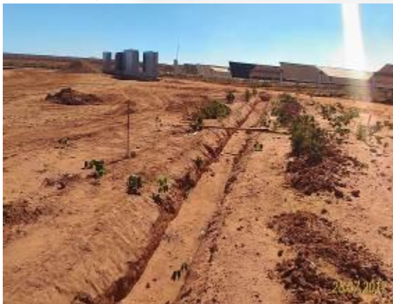
Foto 07. Canaletas sistema drenagem
