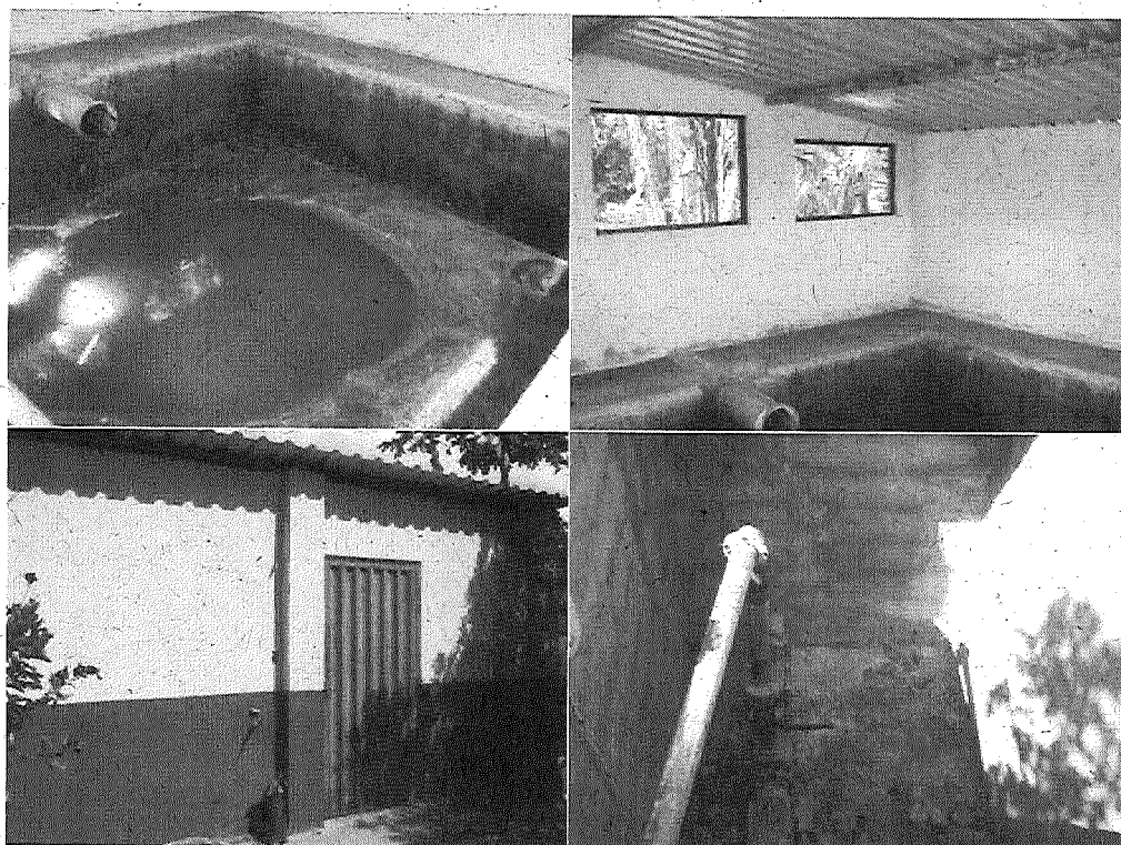
Foto 05. Detalhe do tanque de armazenamento do efluente da higienização e ordenha.
